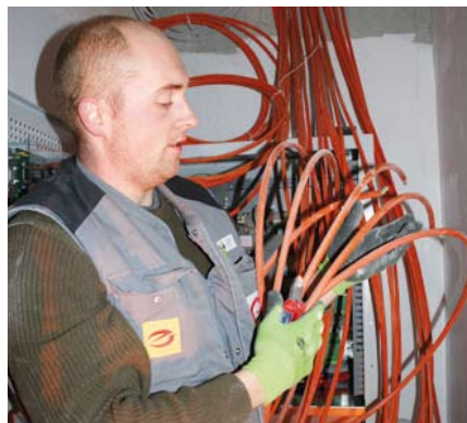
Im Erdgeschoss entsteht die Notlichterzentrale.
