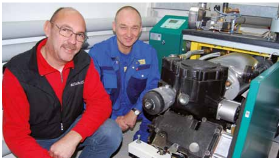
Nachdem er seinen eigenen Dachs auf Herz und Nieren geprüft hatte, schlug SenerTec Center-Partner Heinz Liebhardt (r.) Harald Rott vor, eine KWK-Anlage im Autohaus Rott einzubauen.
