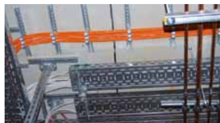
Von Bachner ausgeführt (v. oben): E90-Kabel, allgemeine Verkabelung (AV) und EDV-Trasse.
