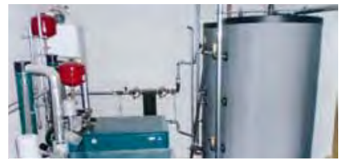
Die Gewerbeeinheiten werden aus einem Kesselhaus mit Strom und Wärme versorgt.
