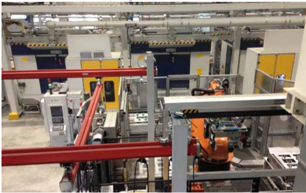
Die Programmierung zur Ansteuerung des Roboterarmes an der Hochdruckstrahlanlage des BMW-Werkes Landshut ist ein typisches Automatisierungsprojekt
