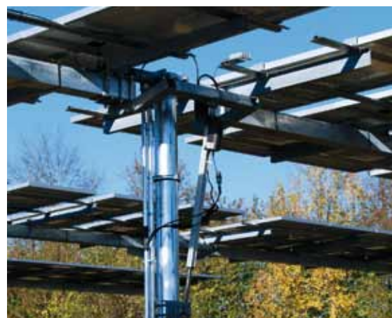
Über das Nachführsystem kann die Schrägstellung der Module geregelt werden.
