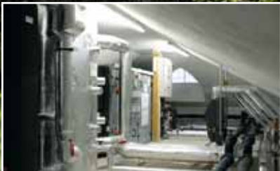
Die komplexen Installationen der zentralen Lüftungsanlage.
