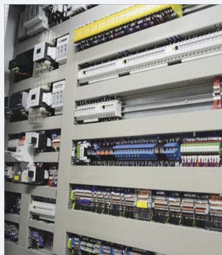
Ein Beispiel eines Verteilers für die verbaute Sicherheitstechnik.
