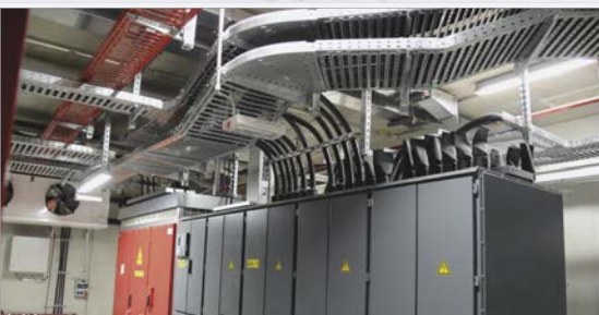
Eine der Trafostationen zur Versorgung von drei leistungsstarken Prüfständen.
