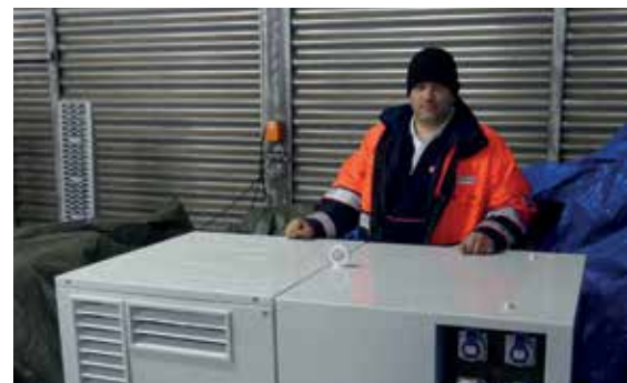
Auch Ehrensache: Das Notstromaggregat – ein Geschenk der Bundeswehr – wurde von den Bachner-Führungskräften Günter Plank und Helmut Schiwampel einsatzbereit gemacht.
