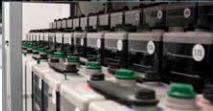
Ein Teil der Batterien für die BSV Stromversorgung im Notfall.
