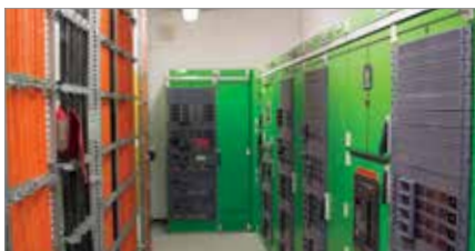
Die SV Hauptverteilung ist ein Herzstück der Installation
