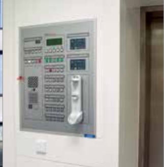
Alle Funktionen im Blick mit zentralen Meldetableaus im Operationsbereich.
