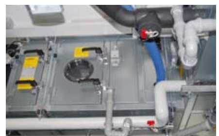
Klima- und Lüftungsverkabelung von Bachner.
