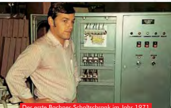
Der erste Bachner-Schaltschrank im Jahr 1971
