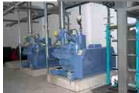
Verkabelung der Kältezentrale.
