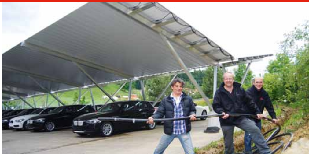
Die Dingolfinger PV-Truppe um Obermonteur Andreas Schaunik (Mitte), Planer Hakan Isik (r.) und Bauleiter Mustafa Cüre übernimmt die Elektroplanung und -installation eines der größten Photovoltaik-Carport-Projekte Deutschlands: Auf dem Gelände der ARS Altmann in Wolnzach entstehen auf 32.000 Quadratmetern 1,7 MWp.
