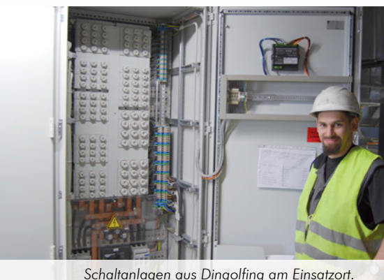
Schaltanlagen aus Dingolfing am Einsatzort.
