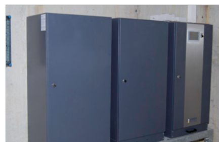
Die XXL-Batterie im Keller der Alten Fabrik hat eine nutzbare Kapazität von 29 kWh.
