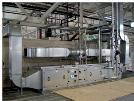
Eine Nebenstelle der Lüftungsanlage.
