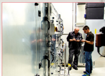
Prüfung und Dokumentation an einem Lüftungsgerät mit Kühlfunktion.
