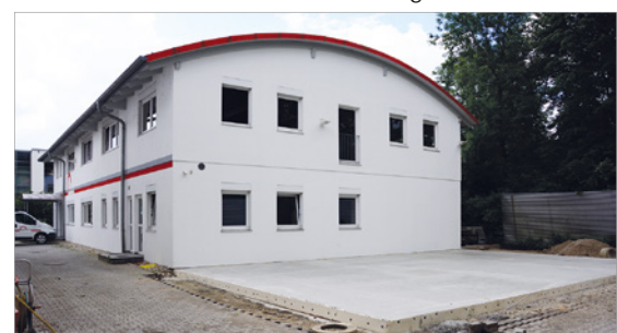
Die Bodenplatte für den Anbau in Dingolfing ist bereits fertig. Der Hochbau beginnt in Kürze.
