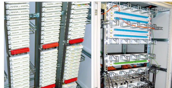
Hier laufen die Stränge zusammen: ELT-Verteiler (oben) und diverse Schwachstromverteiler (unten).
