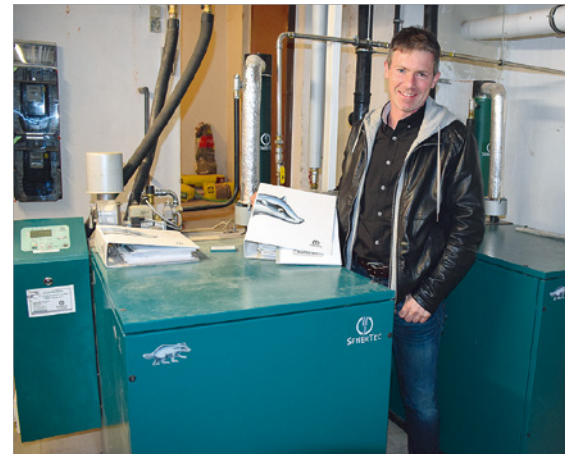
Energieberater Boris Jungbauer im Untergeschoss des Augustiner Wohnheims. Hier schlägt das „Herz“ des Gebäudes: Die Heizzentrale mit zwei Dachsen.
