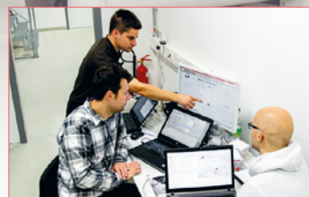
Unscheinbare Zentrale: Von hier aus erfolgt die komplette Steuerung und Bedienung der Anlagen.
