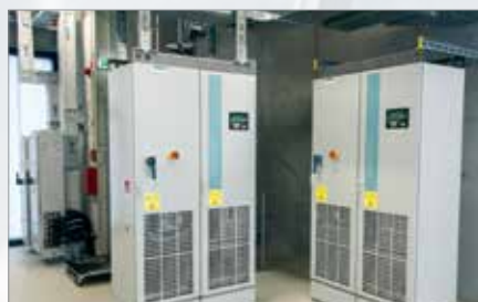
Zwei von vier Frequenzumrichtern zur Steuerung der Ventilatoren.
