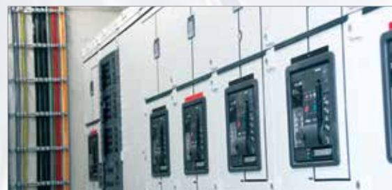
Im Erdgeschoß befindet sich die Niederspannungsunterverteilung.
