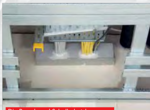
Die Brand- und Schallschutzboxen zur Wanddurchführung der Kabelwege bereits im geschlossenen Zustand.
